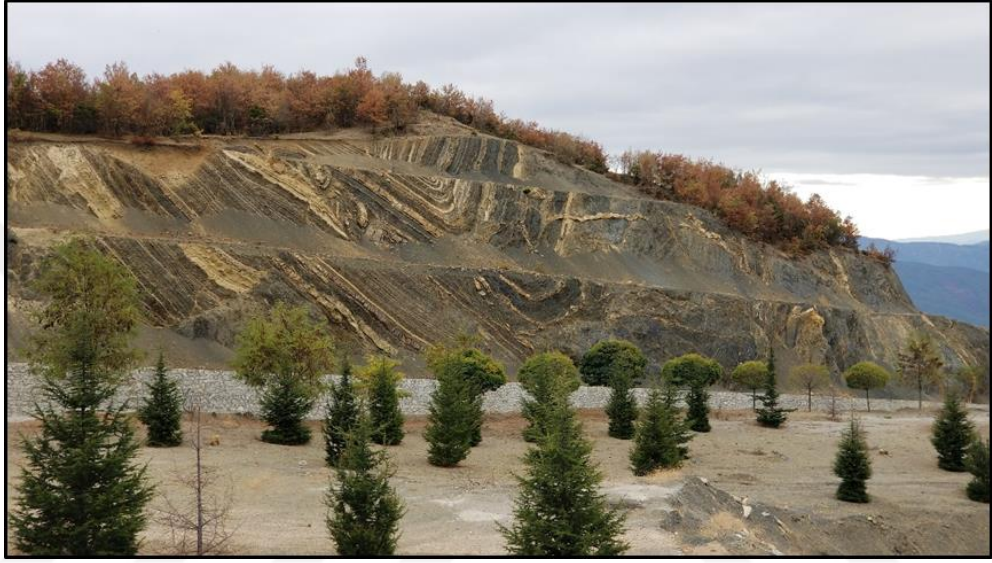
Şekil 3.9. Yol yarmasında ortaya çıkan kıvrımlı yapılar (Durağan-Dikmen karayolu 9,5. km)
