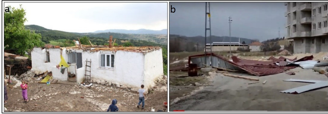
Şekil 3.24. Araştırma sahası ve çevresi dönem dönem fırtınalardan etkilenmektedir. a) 27 Haziran 2014 tarihinde meydana gelen fırtınada Kayabaşı Mahallesi’nde çatısı uçan ev. b) 2019 yılında gerçekleşen fırtınada meydana gelen hasarlardan biri. (Havza25mayıs, 2019)
