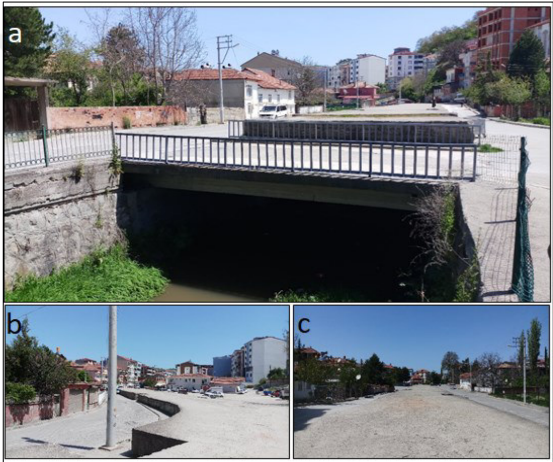
Şekil 3.15. Çayırözü Deresi'nin şehir içindeki 900 m'lik bölümünün üzeri kapalı durumdadır. a) Çayırözü Deresi'nin üstü kapalı bölümünün başlangıcı. b) Çayırözü Deresi'nin üzeri kapalı bölümü ile yol arasında kot farkı bulunmaktadır. c) Çayırözü Deresi'nin üzeri kapalı bölümünün büyük kısmı herhangi bir amaçla kullanılmamaktadır.
