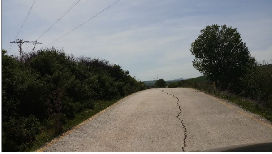
Şekil 3.10. Pınarçay Mahallesi ile Havza ilçe merkezi arasındaki yolda akmaya bağlı olarak uzunca çatlaklar oluşmuştur.
