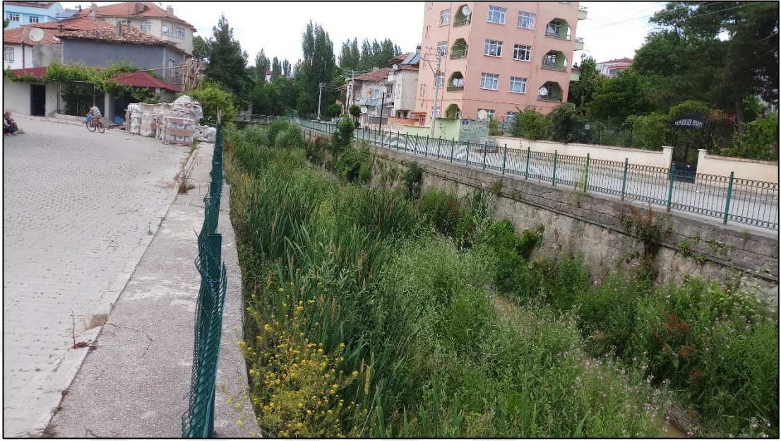
Şekil 3.16. Bahçelievler Mahallesi'nde Çayırözü Deresi'nin yatađı 2020 haziran ayı itibariyle alüvyal malzeme ve bitki örtüsü ile kaplanmış durumdadır.
