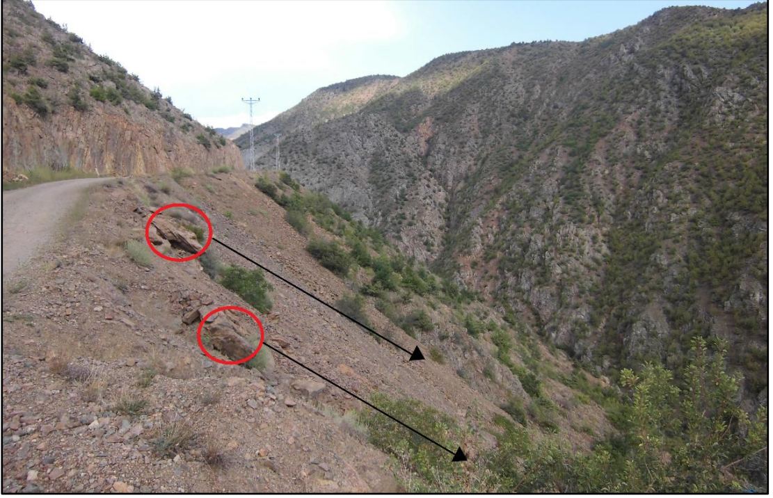
Şekil 3.4. Taşkiran Köyü yakınlarında küçük çapta kaya yuvarlanmaları görülmektedir
