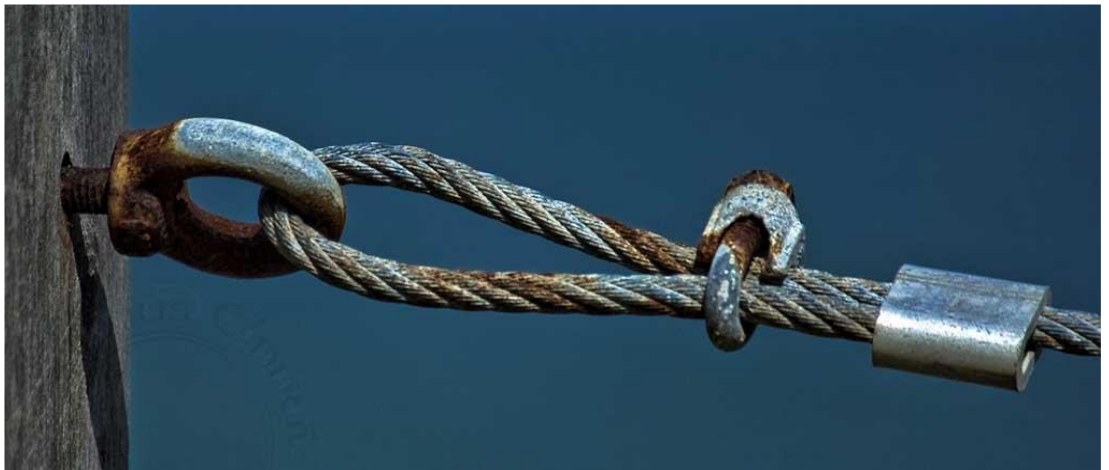
Şekil 3.37. Çelik halatlarda bağlantı noktasında oluşan korozyon
