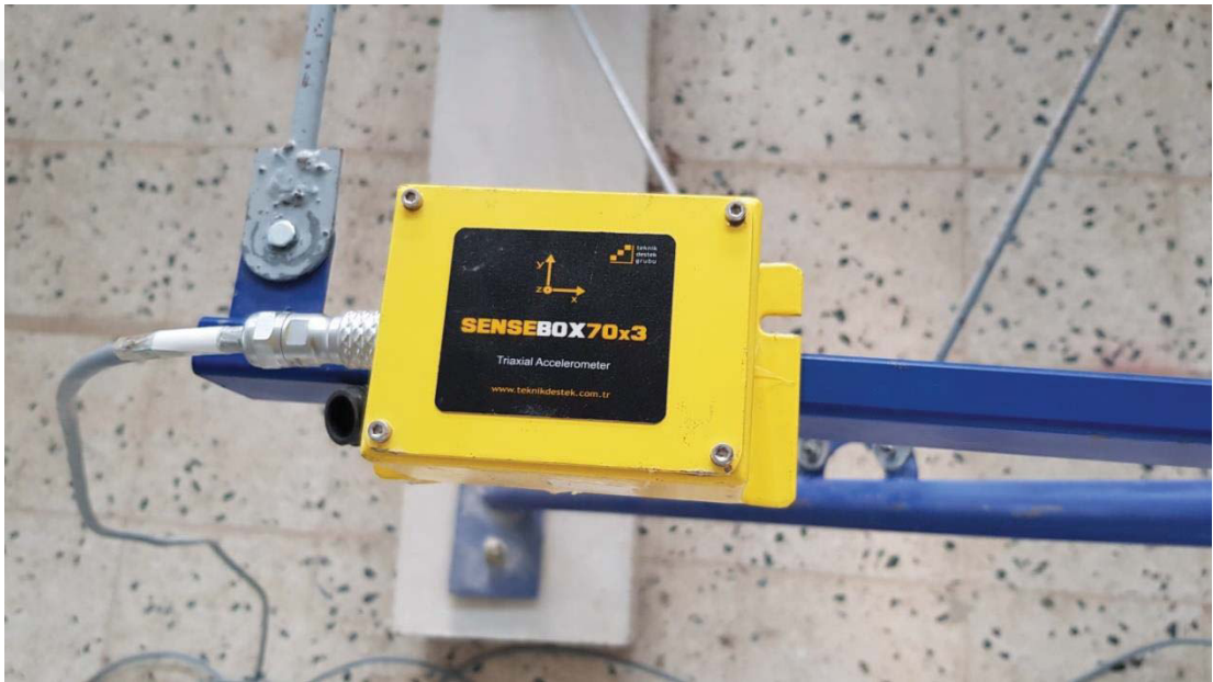
Şekil 4.25. Üç eksenli ivmeölçerin düğüm noktasına yerleştirilmesi
