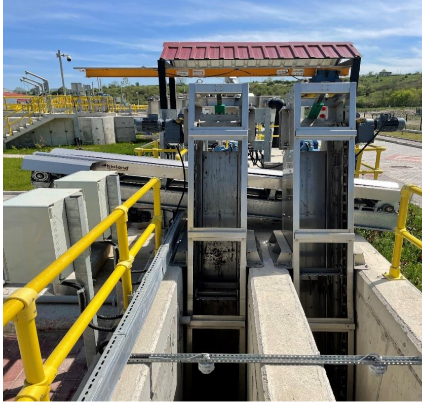
Şekil 3.4. Kaba Izgaralar (Kavak Atık Su Arıtma Tesisi)
