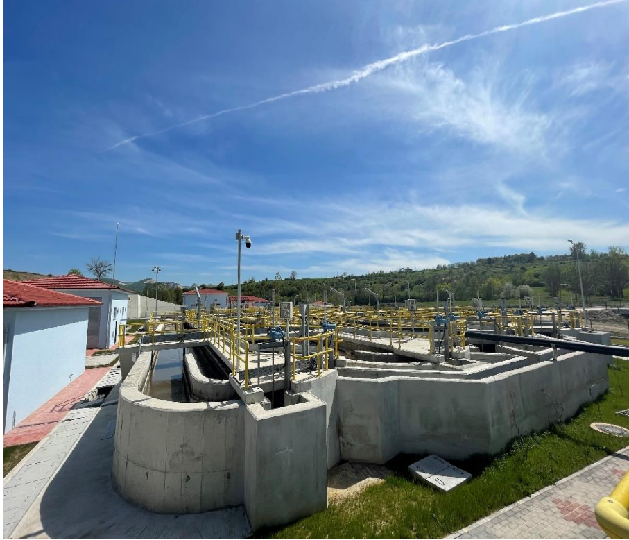
Şekil 3.11. Havalandırma (anoksik ve oksik) Tanklar (Kavak Atık Su Arıtma Tesisi)
