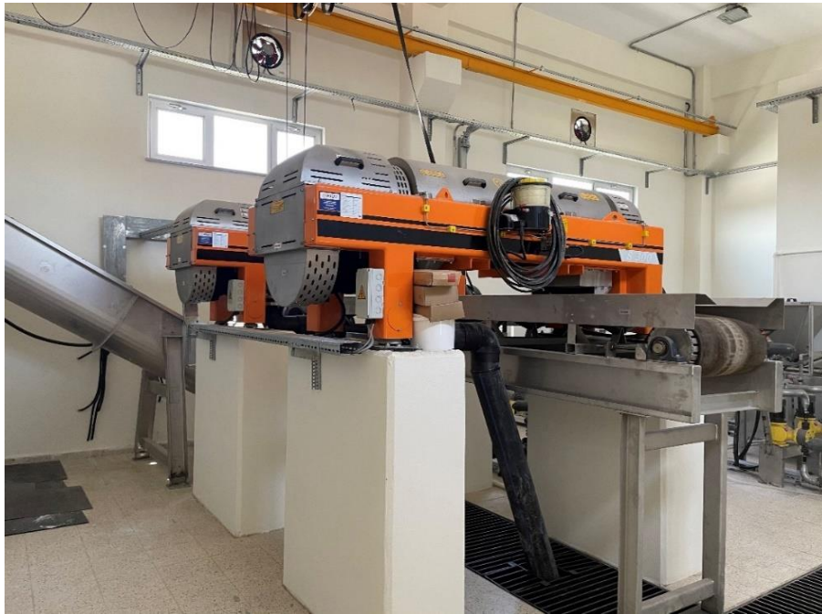
řekil 3.18. amur Susuzlařtırma (Kavak Atık Su Arıtma Tesisi)
