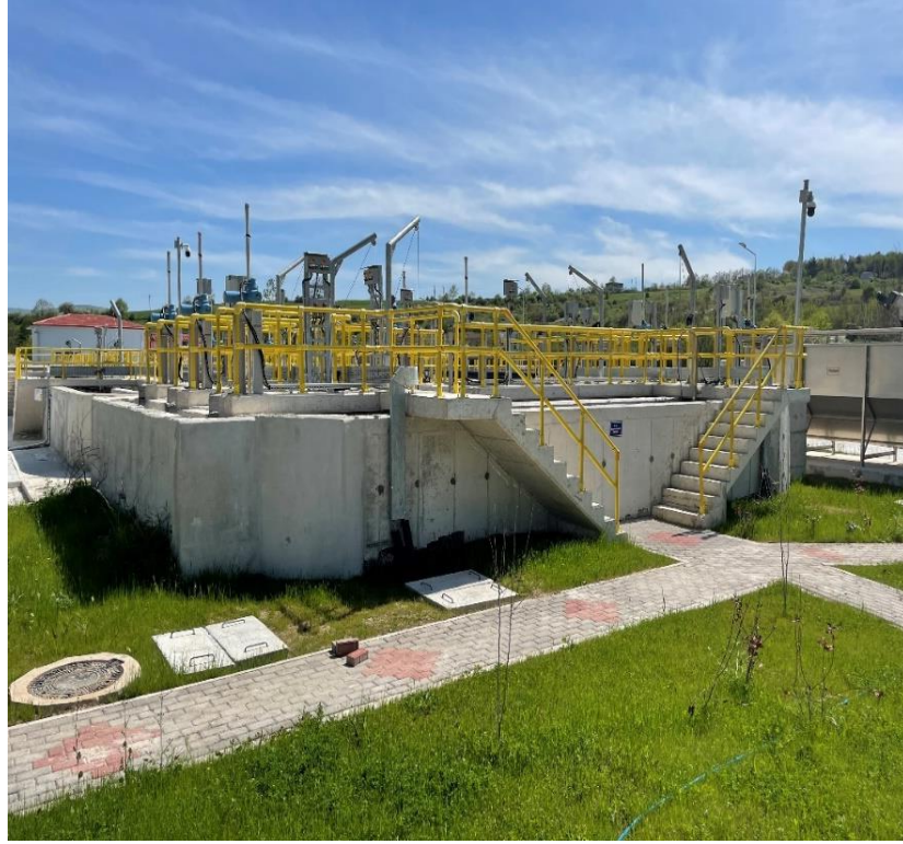
Şekil 3.10. Biyo-Fosfor (Anaerobik) Tanklar (Kavak Atık Su Arıtma Tesisi)
