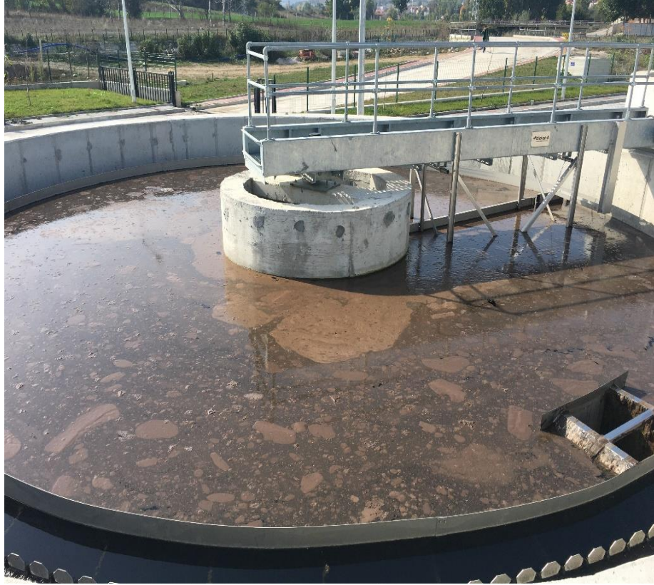
Şekil 2.12. Atık su Arıtma Tesisi Havalandırma Ünitelerinde Oluşan Yükselme Görüntüleri
