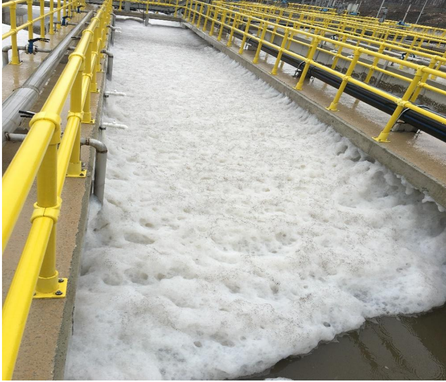
Şekil 2.11. Atık su Arıtma Tesisi Havalandırma Ünitelerinde Oluşan Köpürme Görüntüleri
