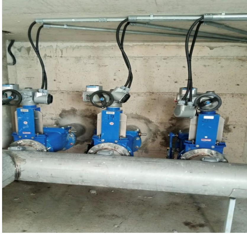
Şekil 3.5. Terfi İstasyonu (Kavak Atık su Arıtma Tesisi)
