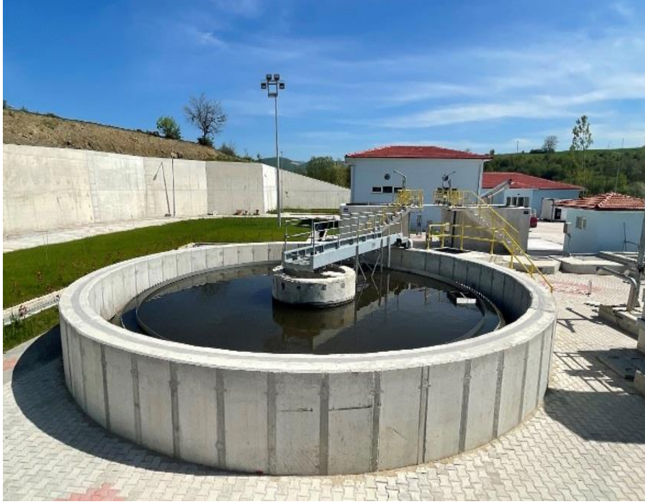
Şekil 3.15. Son Çökeltme Havuzları (Kavak Atık Su Arıtma Tesisi)
