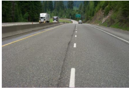
Şekil 2.14. Kapslamada derz çatlağı (PavementInteractive, 2021b)
