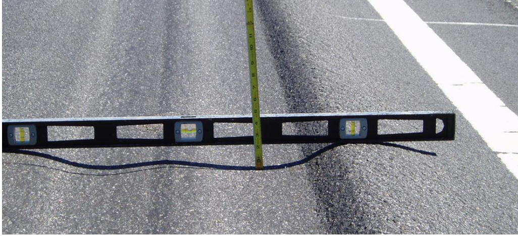
Şekil 2.4. Kaplamada tekerlek izi (Line.17qq, 2021)
