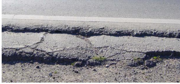
Şekil 2.13. Kapslamada kenar çatlakları
