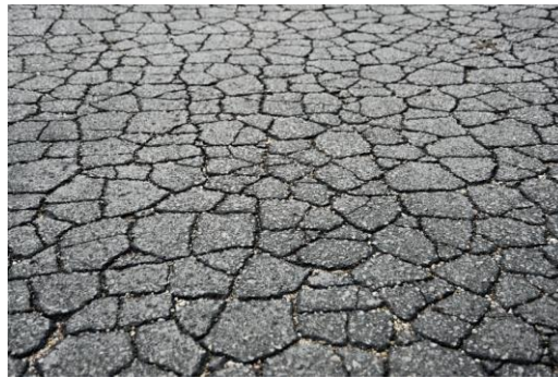
Şekil 2.12. Kaplamada timsah sırtı çatlaklar (RocciesAsphalt, 2021)
