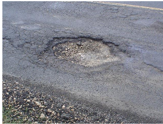
Şekil 2.10. Kaplamada çukur (PavementInteractive, 2021c)
