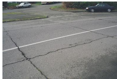
Şekil 2.16. Kaplamada yansıma çatlacağı (PavementInteractive, 2021e)
