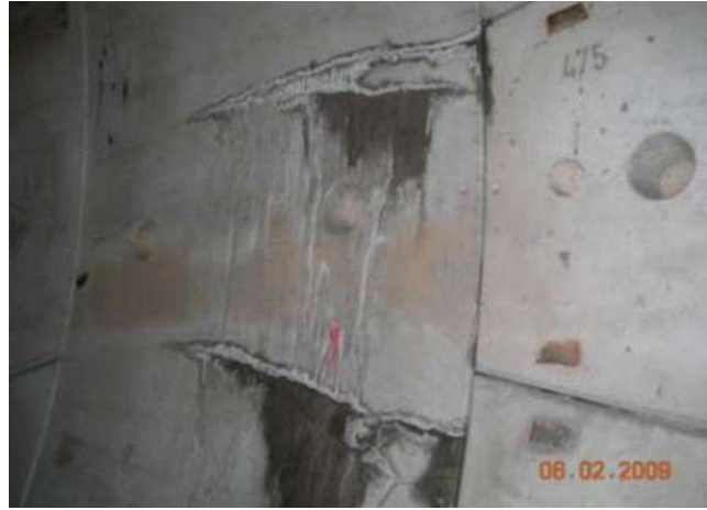
Şekil 5.3. Yapım sırasında sıralanan segmentte görünen çatlaklar
