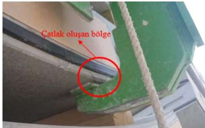
Şekil 5.2. Betonarme prekast segmentlerin yüklenmesi sırasında hasarTünel imal aşamasında
