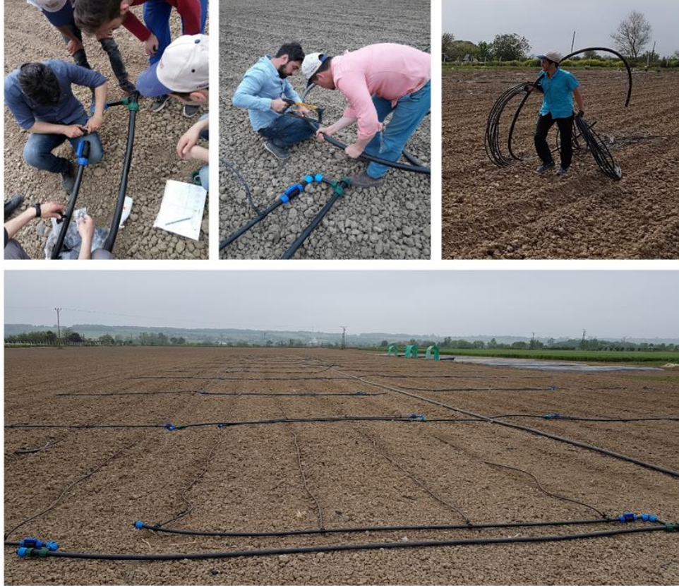
Şekil 3. 9. Damla sulama sistemi kurulumu
