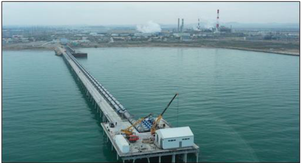
Şekil 60: Sumgayit Termal Enerji Santrali
